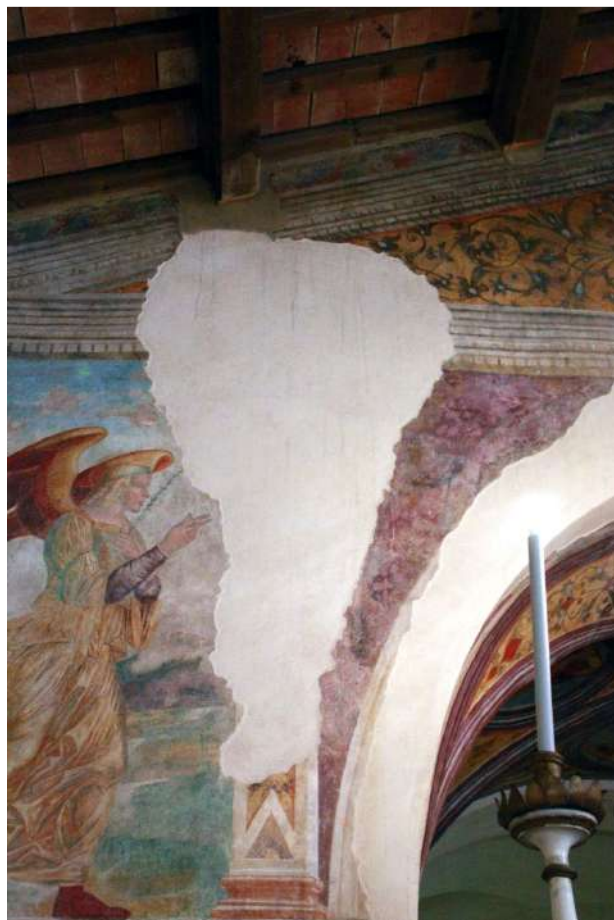
Infiltrazioni dal tetto
