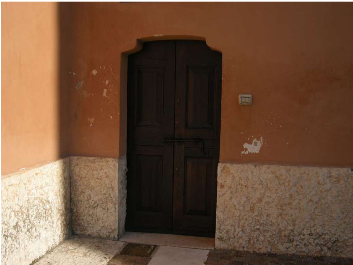
Ingresso laterale a destra della Chiesa con evidenti cadute di intonaco causate dalla risalita capillare
