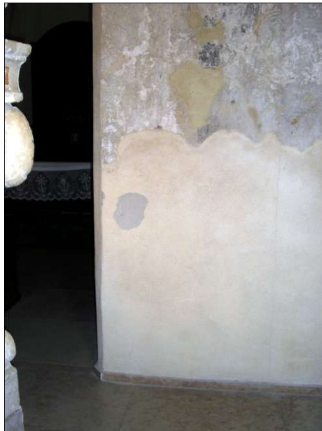
Distacco e disgregazione intonaco
